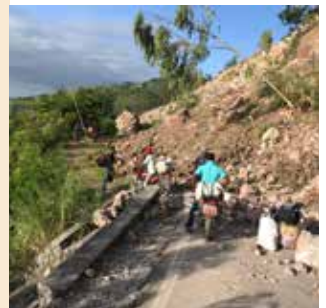
LES ROUTES ET D'AUTRES INFRASTRUCTURES ONT ÉTÉ GRAVEMENT ENDOMMAGÉES LORS DU TREMBLEMENT DE TERRE DE L'ÉTÉ 2021 EN HAÏTI.
